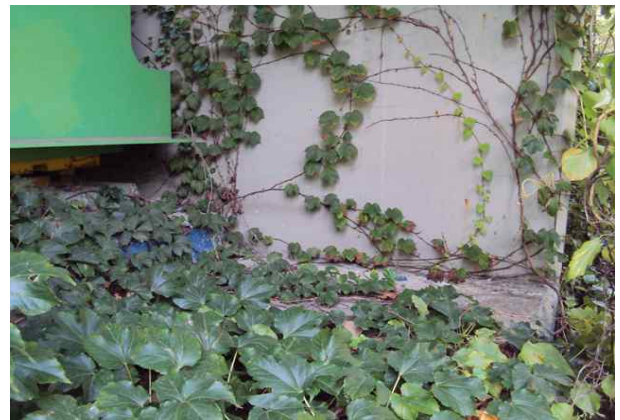
교대 구체 상면 체수흔적
